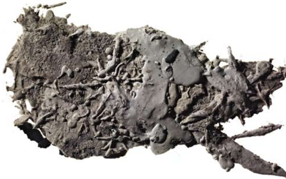
projections de béton de 2 à 20 cm de long, 2010.
